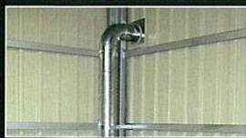
自然換気ダクト
