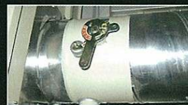
FD付排気ダクト
